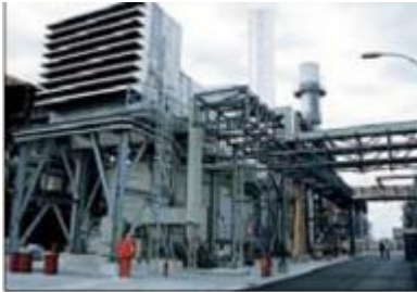
Planta cogeneradora de Torres Motril, IBERDROLA
